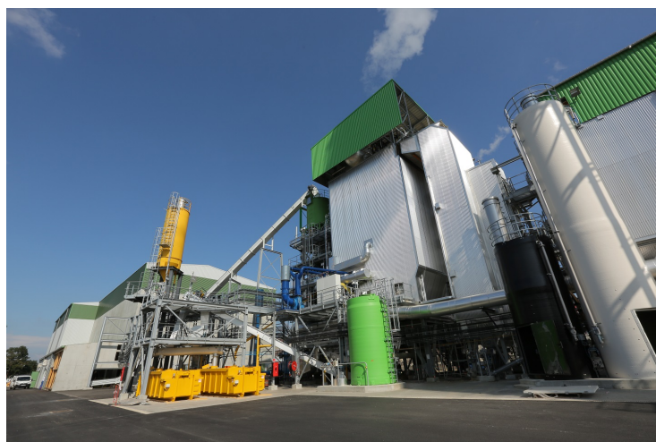
Figure 3. Unité de production de chaleur et de vapeur à partir de biomasse forestière et de biomasse déchets à Roussillon (Isère). Lauréat de l'appel à projet du Fonds Chaleur pour la biomasse, le BCIAT, Cette installation, opérée par SITA, filiale de SUEZ ENVIRONNEMENT, permettra d'alimenter 15 industries chimiques de la plateforme en vapeur « décarbonée ». (photo : Ademe)
